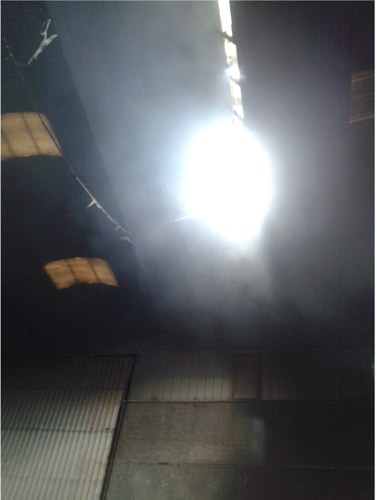
- Foto 9 – 10.09.2016, soffitto capannone luogo dell'incendio
