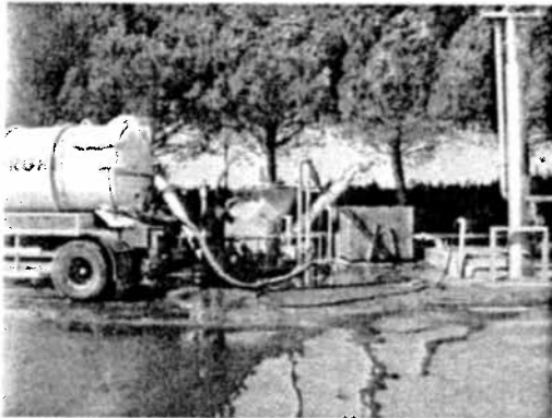
piazzola scarico rifiuti liquidi
