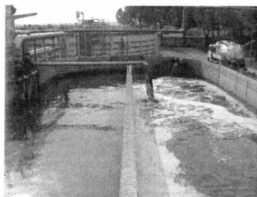
vasca denitrificazione, linea B
