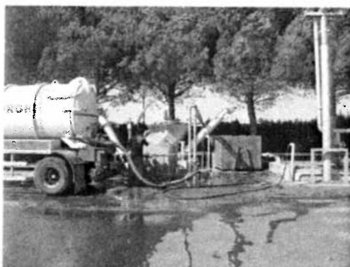
piazzola scarico rifiuti liquidi
